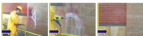
Chemiczne usuwanie graffiti z betonowego prefabrykatu (Amerblok), przy użyciu środków AGS 2+, AGS 60
