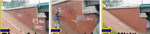
Chemiczne usunięcie graffiti z cegły / klinkieru w Śródmieściu przy Szybskiej 60, AGS 2+, AGS 60
